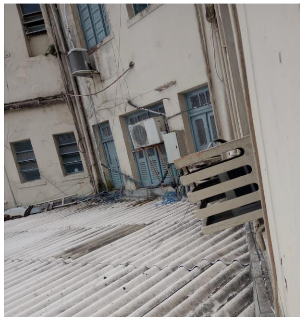
12. CABEAMENTO E FIOS SOLTOS POR CIMA DO TELHADO
