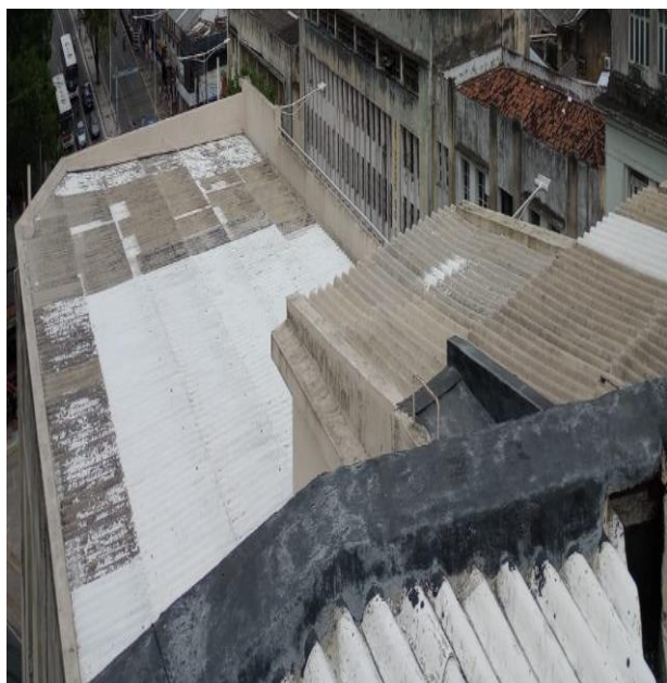
11. IMPERMEABILIZAÇÃO DEFICIENTE NA COBERTA
