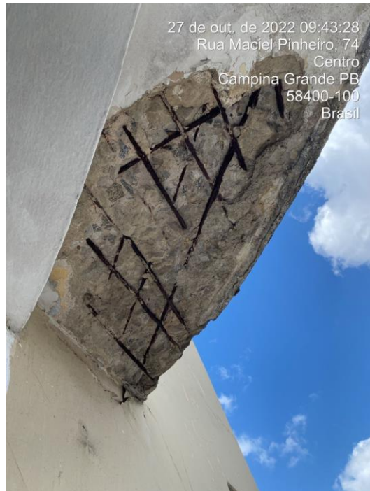
10. ARMADURA COM AVANÇADO ESTADO DE CORROSÃO
