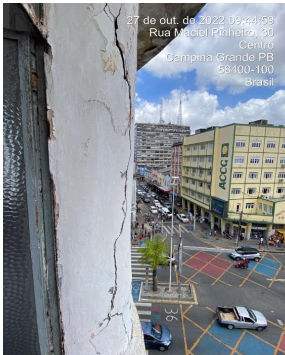
9. FISSURA E DESPLACAMENTO DE REBOCO
